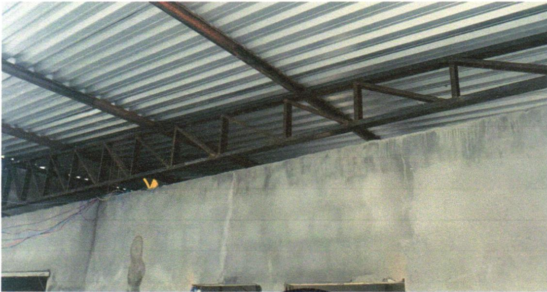
Foto 30 - FABRICAÇÃO E INSTALAÇÃO DE TESOURA INTEIRA EM AÇO, VÃO DE 10 M, PARA TELHA ONDULADA DE FIBROCEMENTO, METÁLICA, PLÁSTICA OU TERMOACÚSTICA, INCLUSO IÇAMENTO. AF_12/2015
