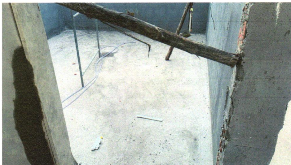
FOTO 06 – (COMPOSIÇÃO REPRESENTATIVA) DO SERVIÇO DE CONTRAPISO EM ARGAMASSA TRAÇO 1:4 (CIM E AREIA), EM BETONEIRA 400 L, ESPESSURA 3 CM ÁREAS SECAS E 3 CM ÁREAS MOLHADAS, PARA EDIFICAÇÃO HABITACIONAL UNIFAMILIAR (CASA) E EDIFICAÇÃO PÚBLICA PADRÃO. AF_11/2014
